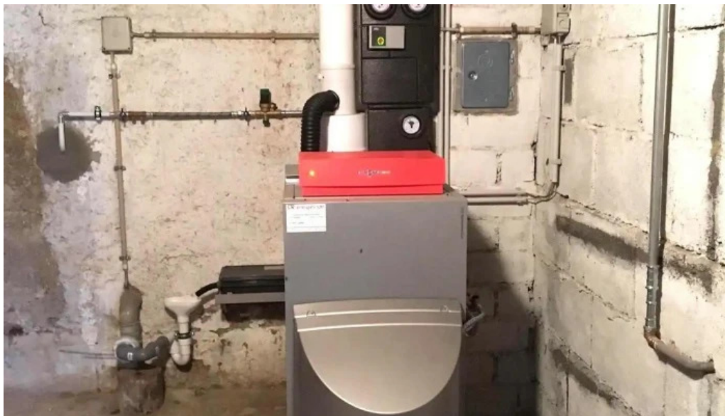
Energies plus sarl maschine
