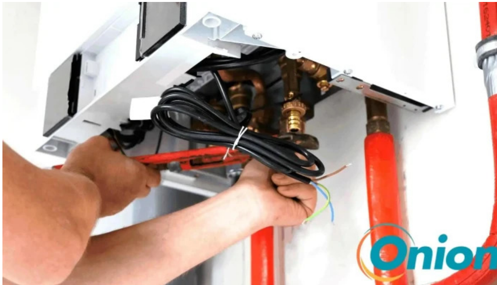
Chauffage sanitaire n kimmel sarl kiischpelt
