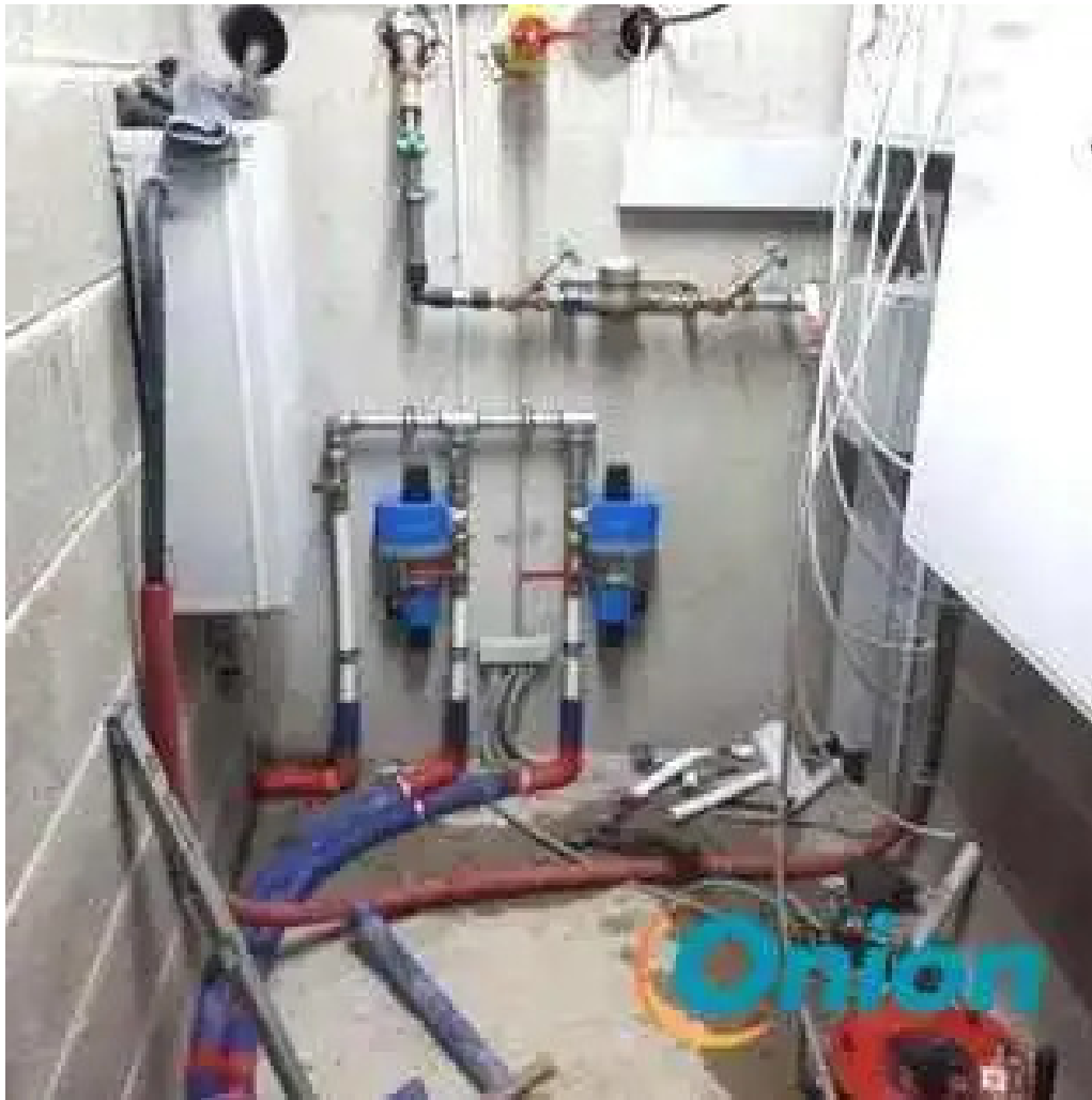
Pro termic sarl innenansichten
