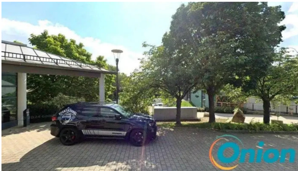
Chargy charging station habscht
