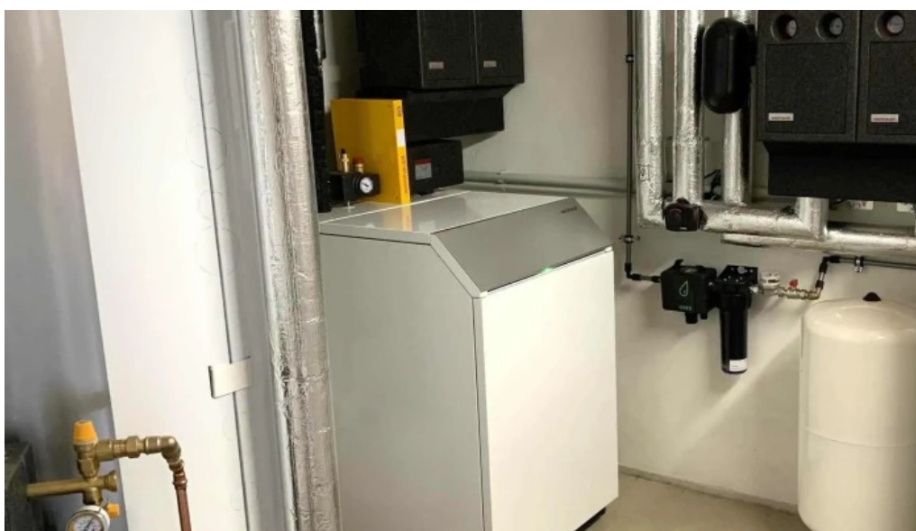
Schlien sarl mein bad meine heizung junglinster
