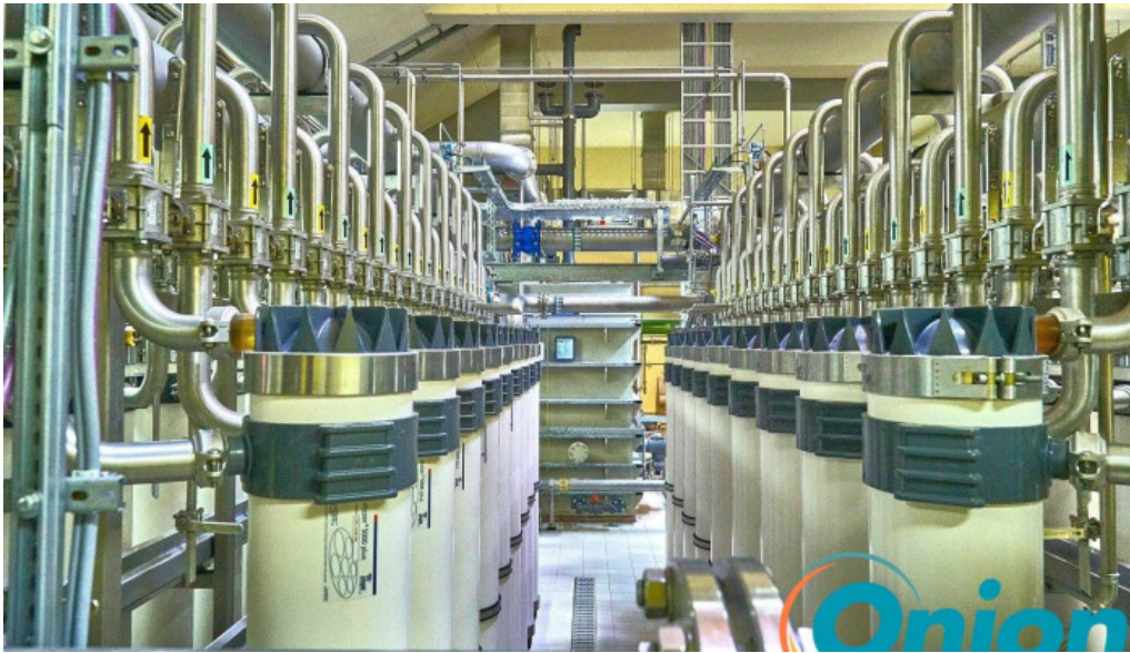
Service des eaux ville de luxembourg vom inhaber
